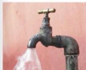
Doc. 6 Une canalisation d'eau.
